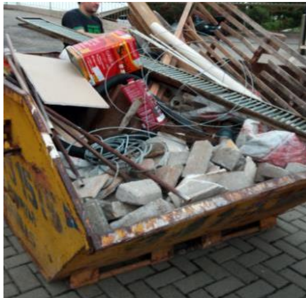
Figura 5 – Ausência de triagem dos resíduos
