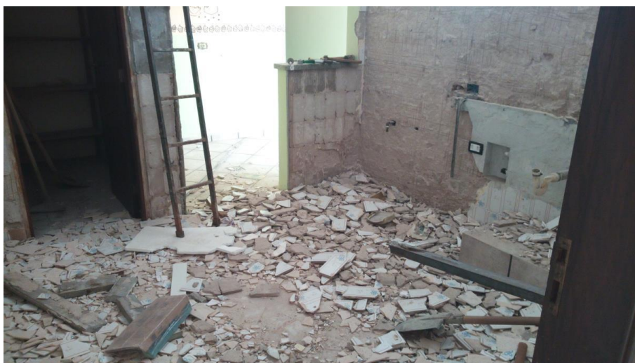
Figura 2 – Entulho de obra
