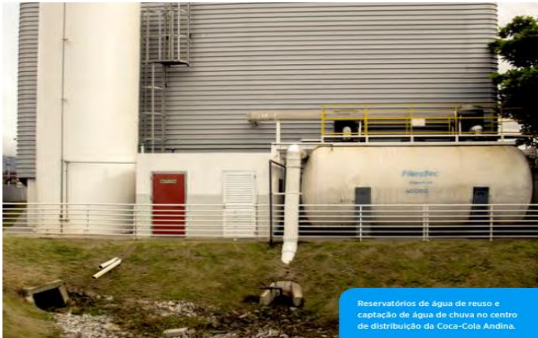
Figura 16- Reservatório de água de reúso em indústria de bebida
