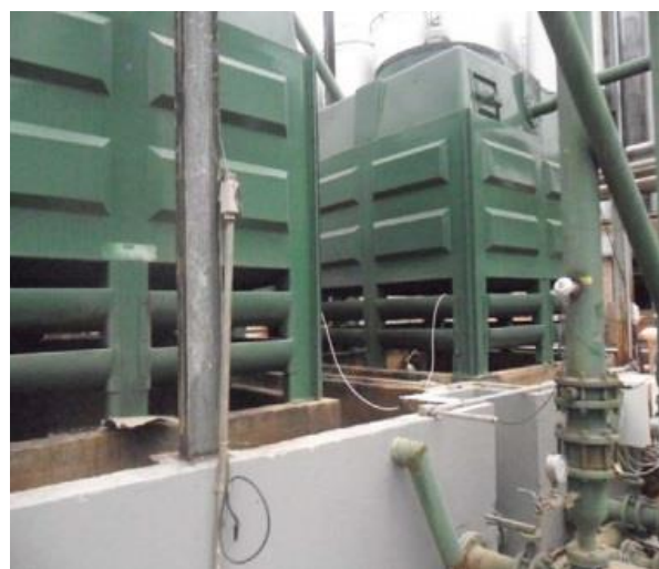
Figura 11- Torre de resfriamento
