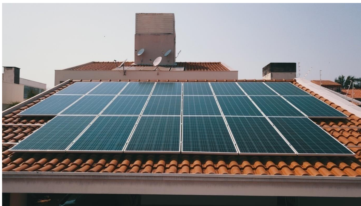
Figura 3 – Painéis fotovoltaicos montados sobre telhado
