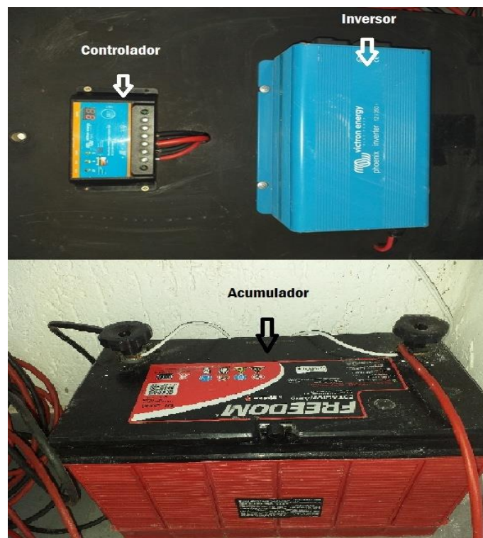
Figura 1 - Componentes do sistema fotovoltaico off grid .
