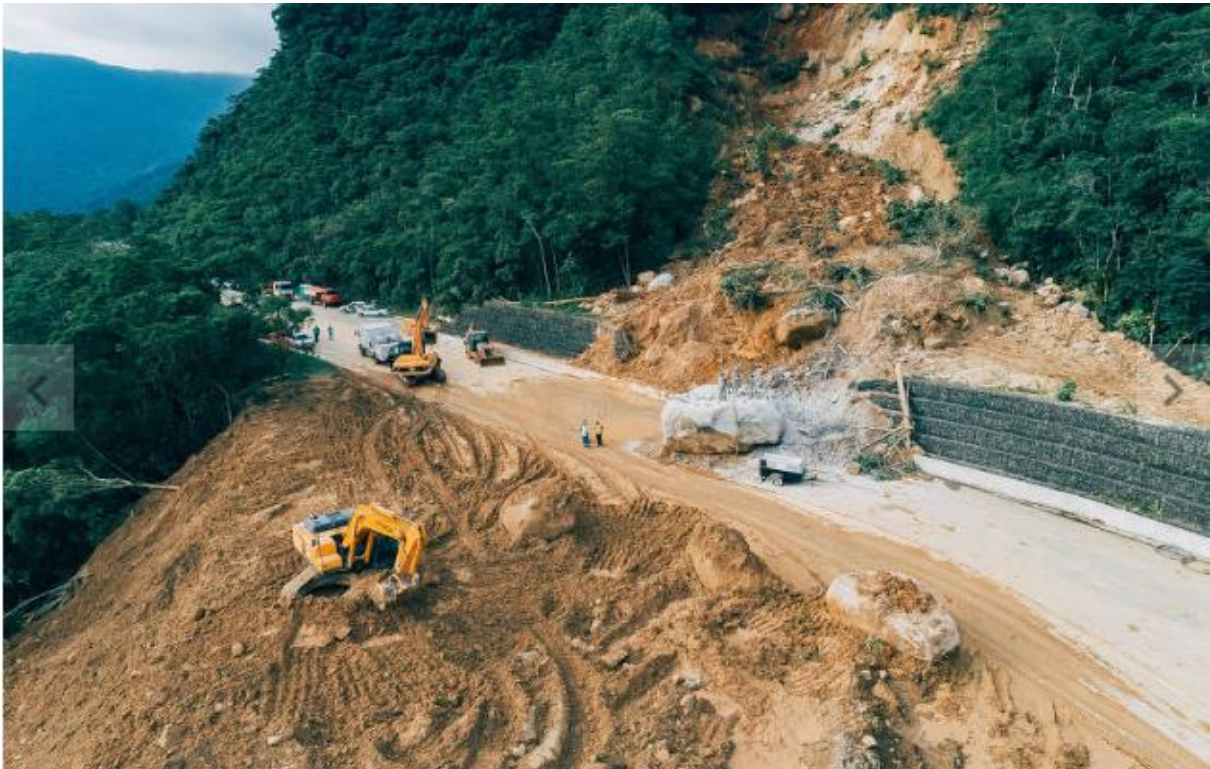
Figura 2 – Deslizamento na Mogi-Bertioga / 21 de dezembro de 2018
