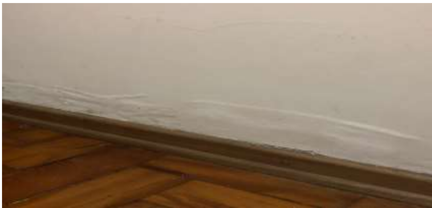
Figura 8 – Parede com infiltração
