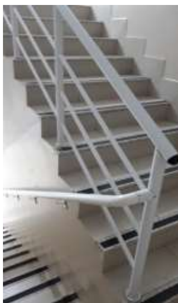
Figura 6 – Corrimão da escada de acesso a sala de aulas do 1º andar utilizado pelo curso de Engenharia Civil
