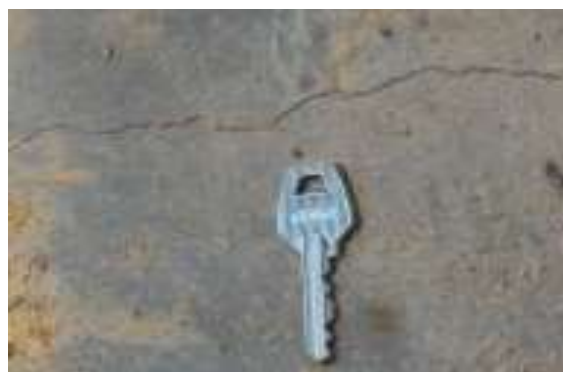
Figura 6 - Trincas após 48 horas da conclusão.
