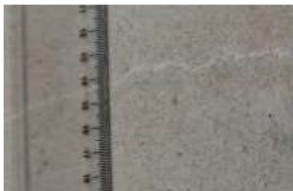
Figura 5 - Trincas após 24 horas da conclusão. dia.
