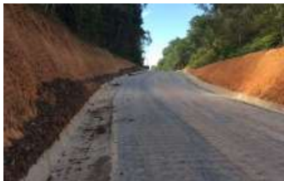
Figura 4 - Aspecto final do trecho no 490º dia.
